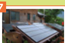
7 太陽光発電パネル 東電小屋・富士見峠公衆トイレの2ヶ所に太陽光発電を導入しています。
