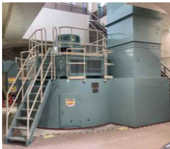
発電機（工事後）
