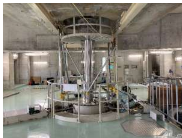
水車（工事後：立軸）
