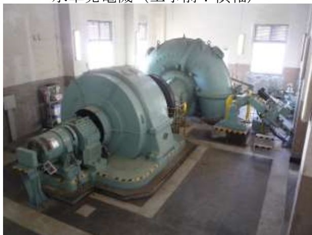
水車発電機（工事前：横軸）
