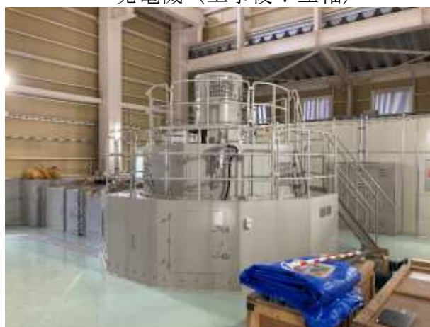
発電機（工事後：立軸）
