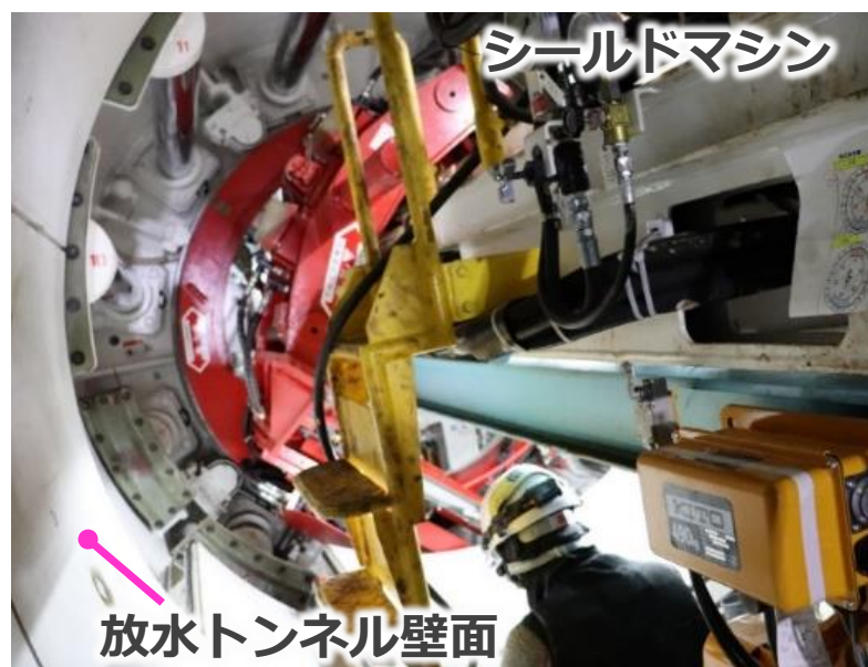
図 23 シールドマシン掘進作業(シールドマシン内部で後方から前方部を撮影)
