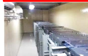
所内常設直流電源設備 （3系統目）
