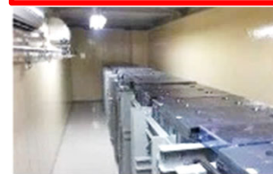
所内常設直流電源設備 (3系統目)
