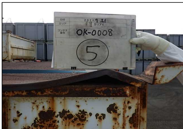
コンテナ1（補修前）
