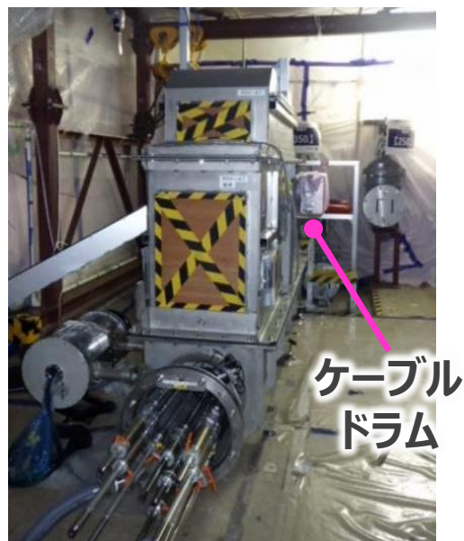
図 23 装置の設置状況
