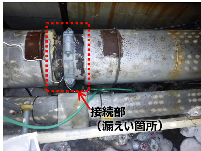
図 3 配管接続部漏えい箇所
