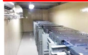
所内常設直流電源設備 (3系統目)
