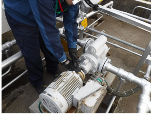
手動による燃料移送ポンプの運転
