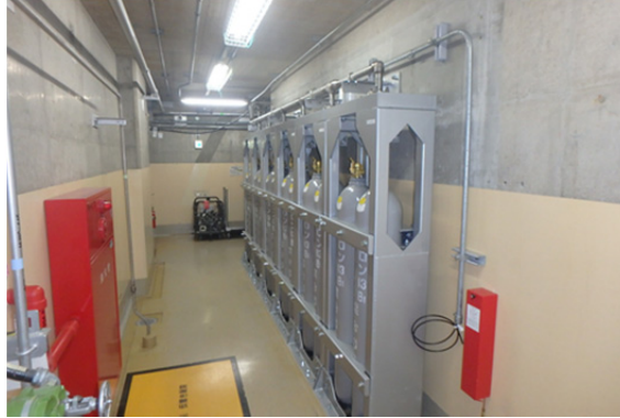
固定式消火設備用ポンベ
