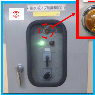
【排水ポンプ制御盤】
