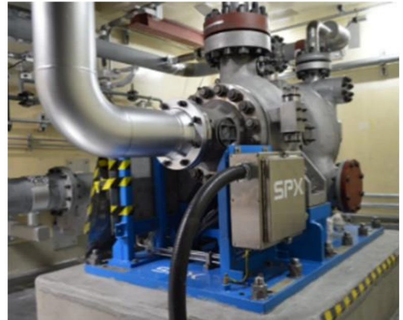
高圧代替注水ポンプ
