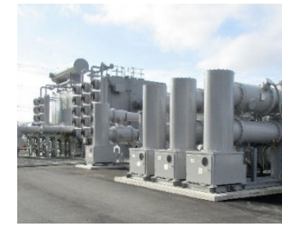
福島送電 都路変電所
