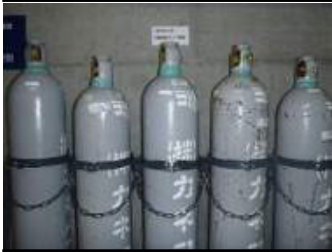
予備ポンベの配備
