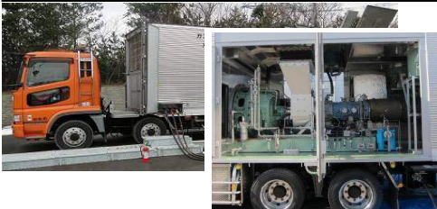
ガスタービン発電機車 (高台配備)
