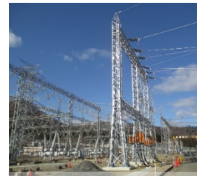
新福島変電所
