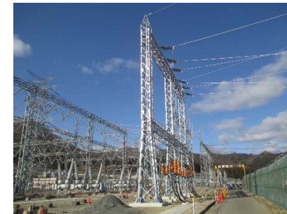
新福島変電所
