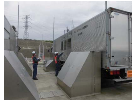
<ガスタービン発電機車操作訓練>
