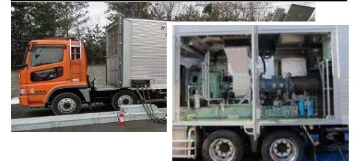
ガスタービン発電機車 (高台配備)
