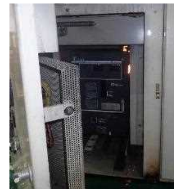
消火前の盤内の様子 (盤扉は消火のために手動開)
