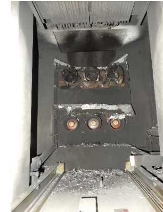
盤内開口部の状態(遮断器室)
