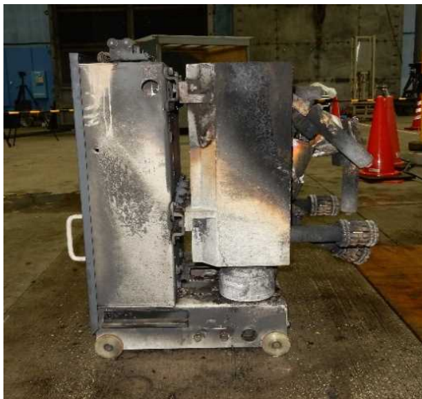
遮断器室アーク発生, アーク火災有, 消火後の遮断器の様子
