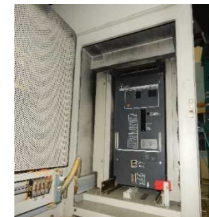
試験後の盤正面の状態
