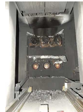
盤内開口部の状態(遮断器室)
