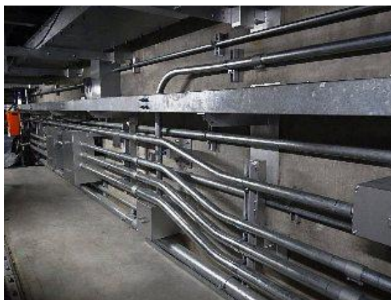
ケーブルトレイ，電線管の例
