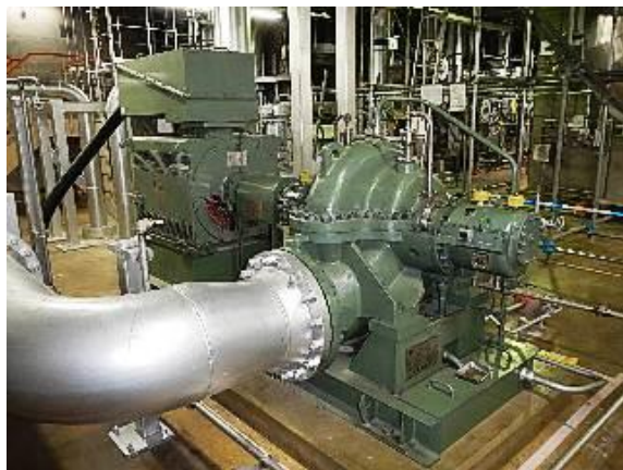
ポンプ，配管，支持構造物の例
