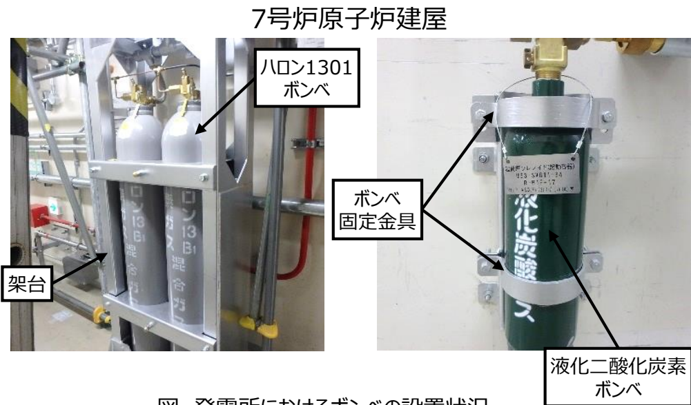
図 発電所におけるポンベの設置状況
