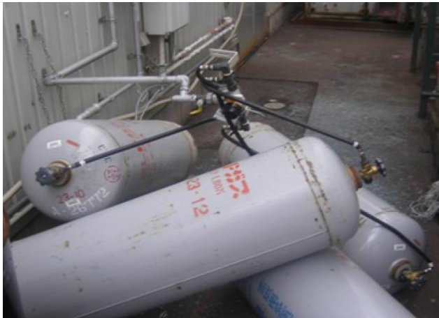
図 東日本大震災でのLPガスポンベの被災状況
