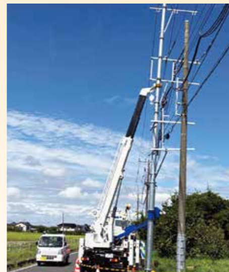
効率的な作業のために新工法を導入(元位置車両建替工事)
