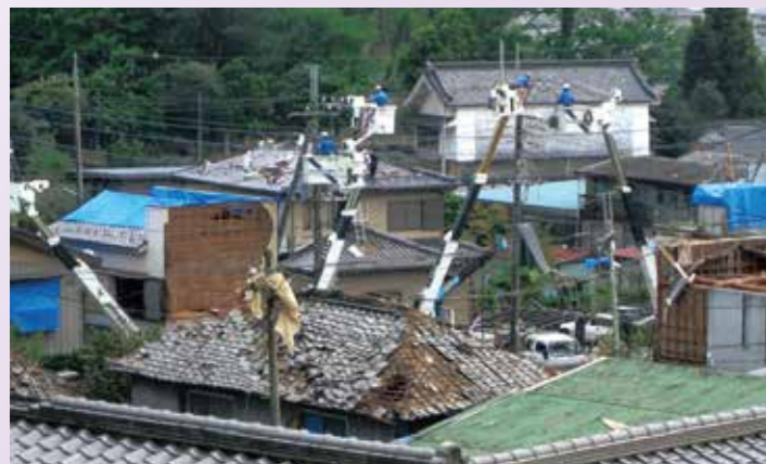
竜巻による設備被害
