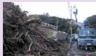
土砂崩れによる設備被害
