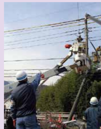
自動車衝突による設備被害
