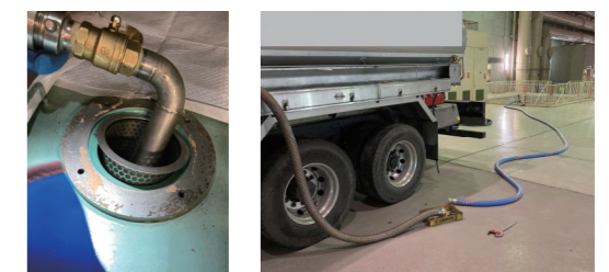
潤滑油の注油作業
