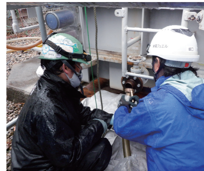
潤滑油の注油作業
