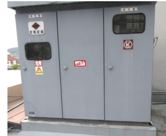
老朽化した屋外キュービクル
