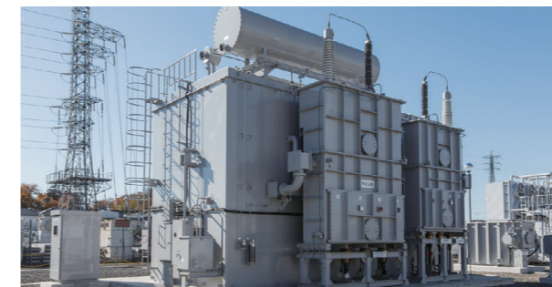
275kV 150MVA 超高压変圧器
