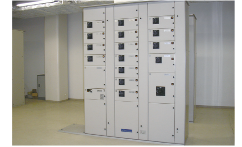
コントロールセンター
