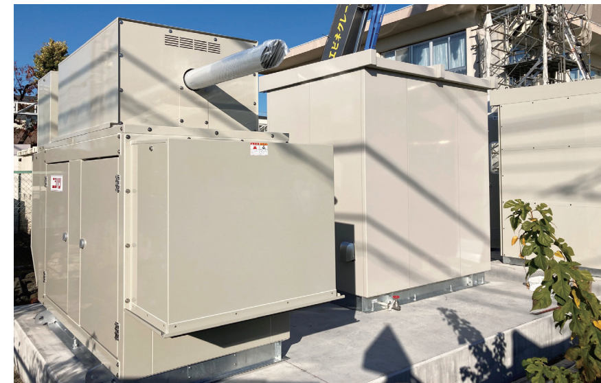
非常用発電機・燃料タンク
