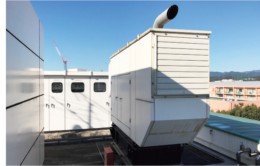
非常用発電機の屋上設置例
