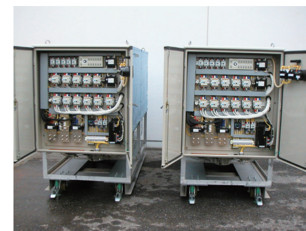
模擬負荷試験装置(開扉)
