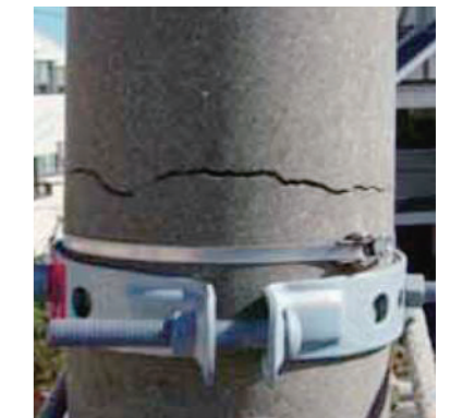
○横ひび・亀裂
