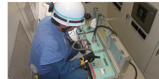
ケーブル劣化診断 (交流重畳法/活線診断)
