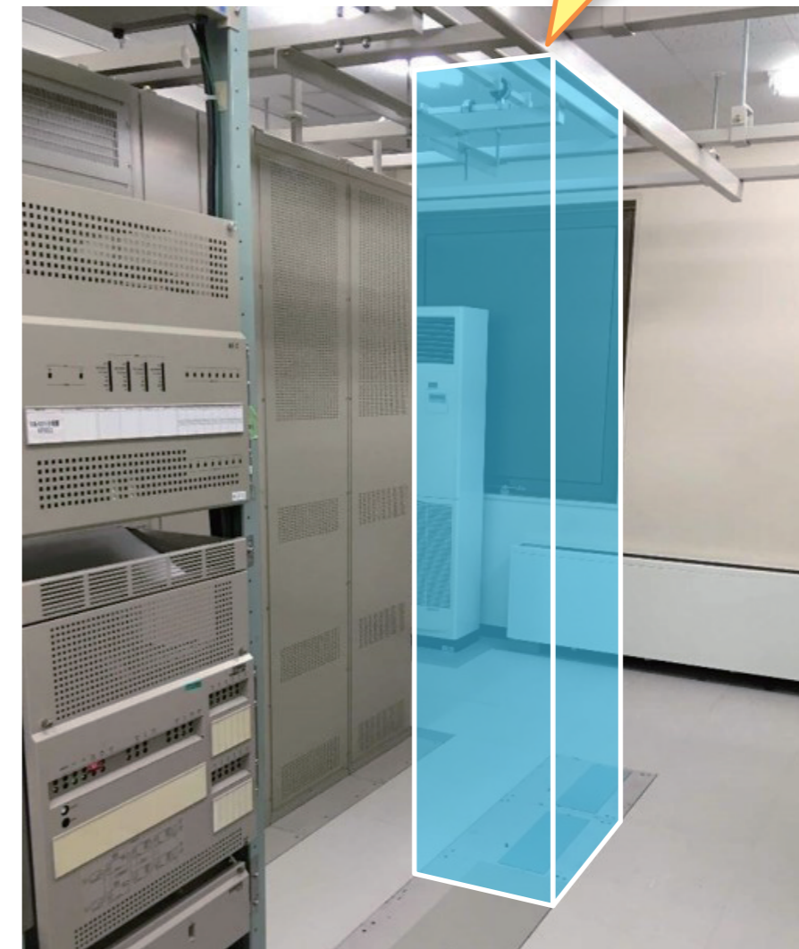
通信機器設置スペース貸し例
