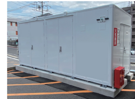
【中型モデル】 出力*100kW 容量400kWh
