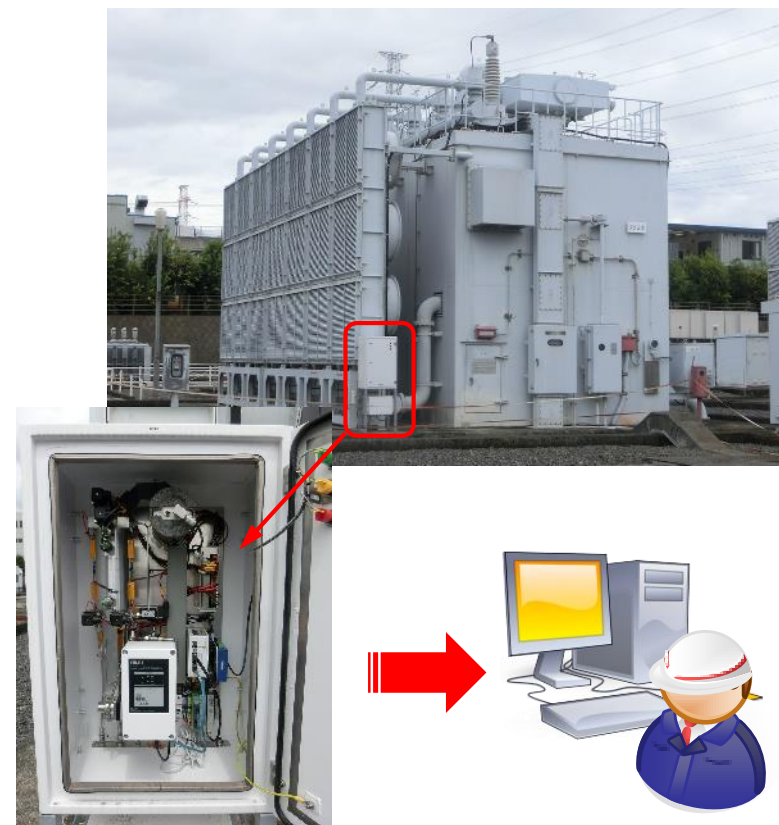
油中ガス分析装置
