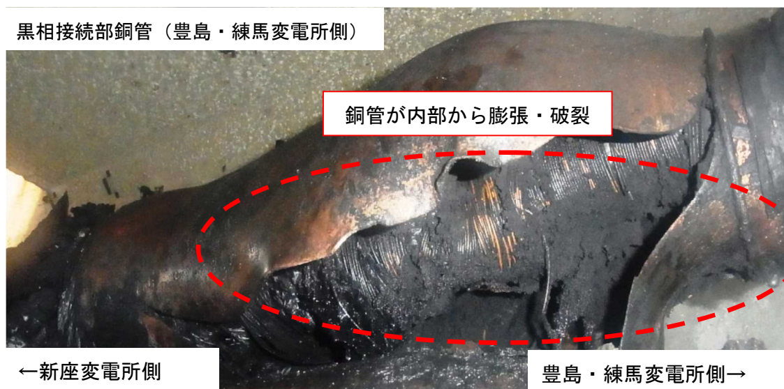
【城北線 3 番黒相接続部の状況（写真②）】
