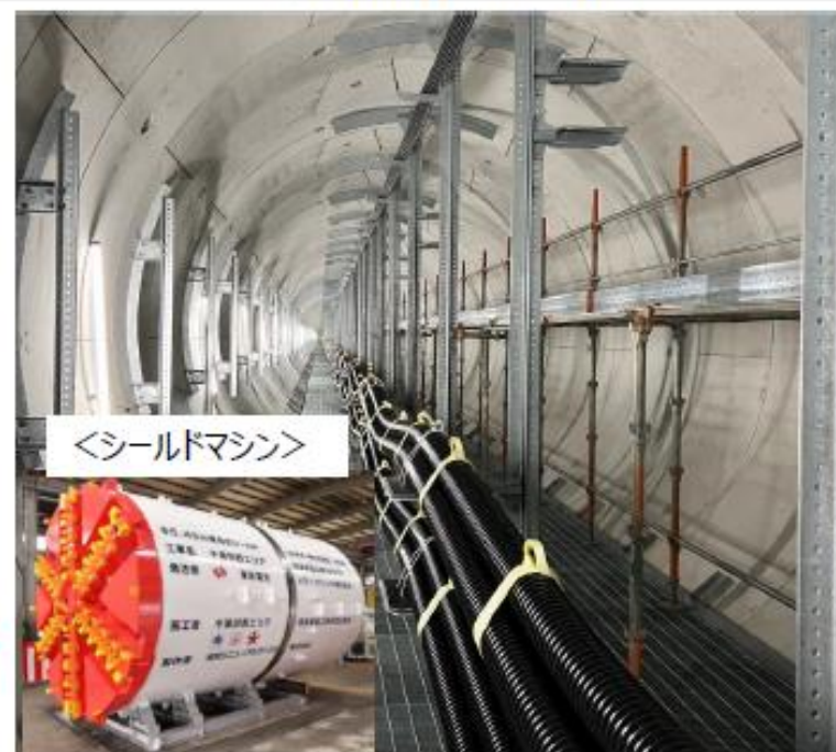
千葉印西エリア洞道内
