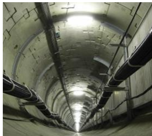
送電設備(地中)
