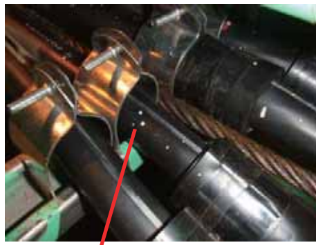
ケーブルボックスゴムカバー破れ
