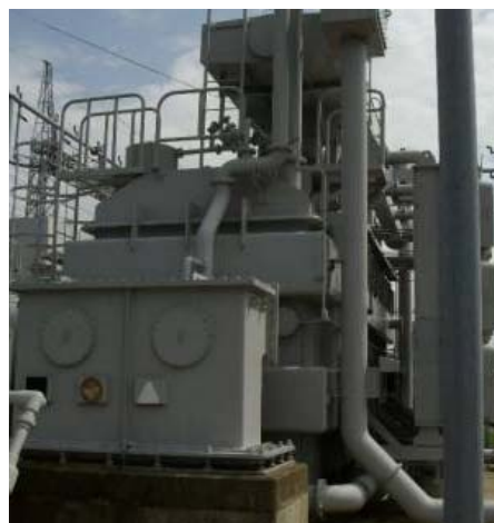
3号高起動変圧器
