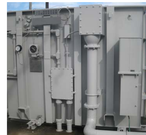
3号高起動変圧器 中性点接地装置
