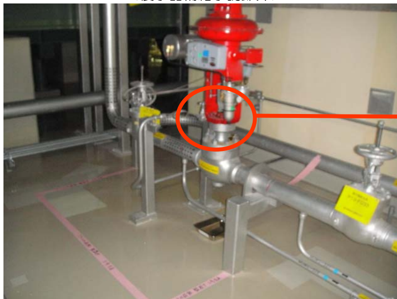
<復水器補給水調節弁>
