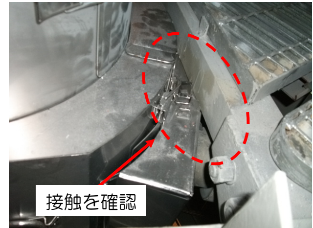
保温材の接触状況
