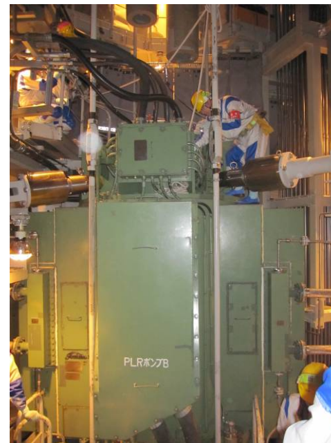
原子炉冷却材再循環ポンプ(B) 電動機の運転状態の確認
