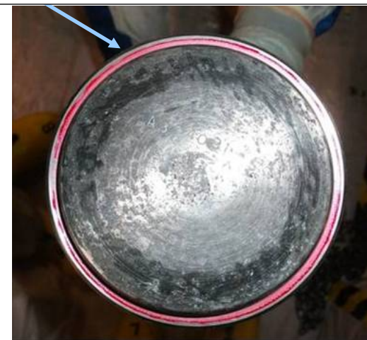
シート面の当たり状況（手入後）
