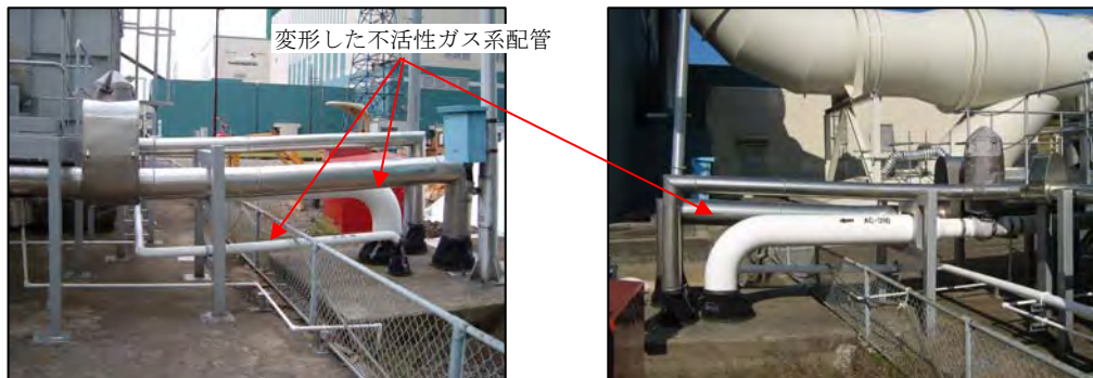
図－1 不活性ガス系配管変形状況
