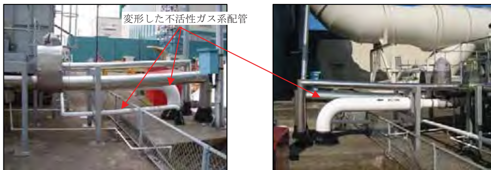
図－1 不活性ガス系配管変形状況
