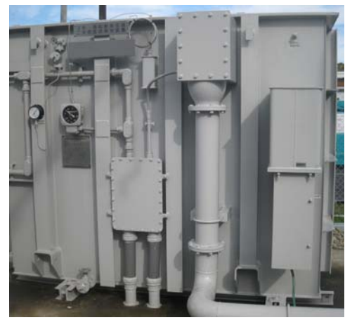
3号高起動変圧器 中性点接地装置
