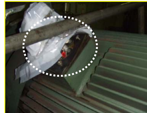
端子箱の破損
