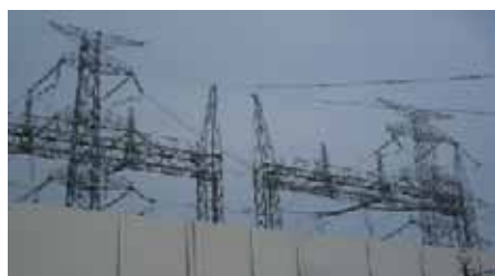
超高圧開閉所
