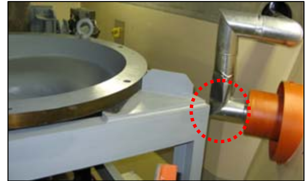
機材が地震の影響で移動し接触
