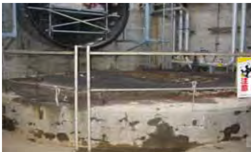
A号機：ポンプベース上面写真（2）
