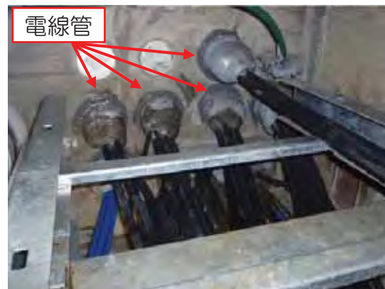
電線管による壁貫通部
