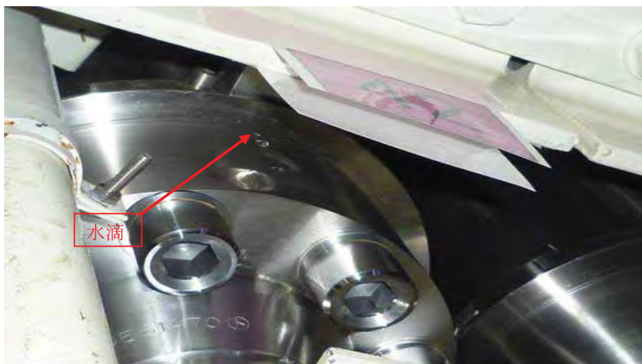
図－1 制御棒駆動機構フランジ部からの漏えい事象
