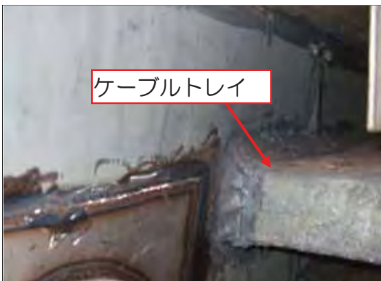
ケーブルトレイによる壁貫通部
