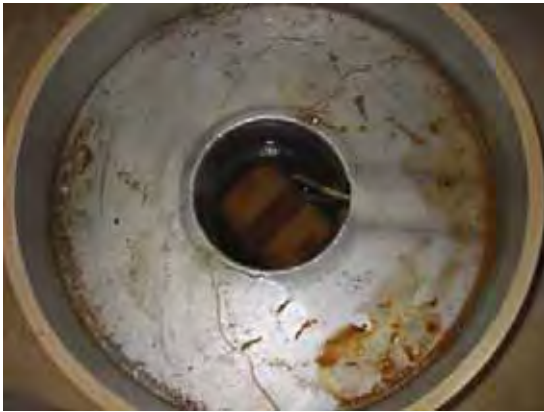
放射線モニタ検出器の水没状況
