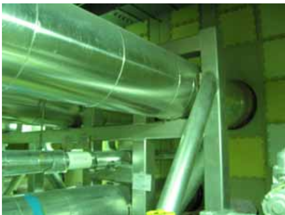
原子炉建屋側貫通部
