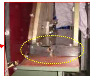
バイク板の損傷状況
