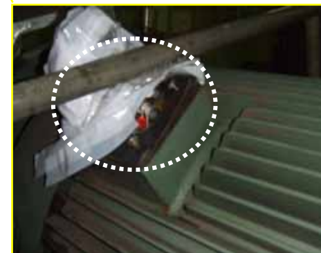
端子箱の破損
