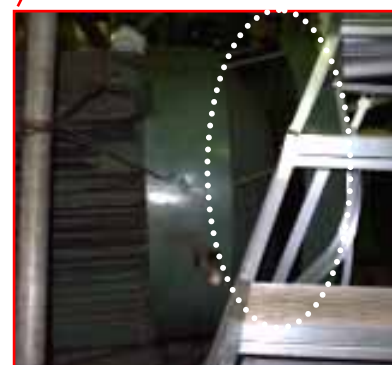
上部カバーの破損
