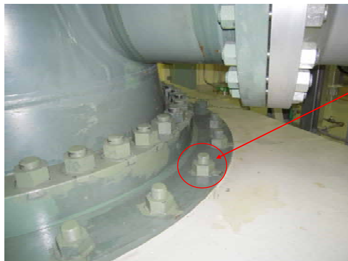
当該基礎ボルト
