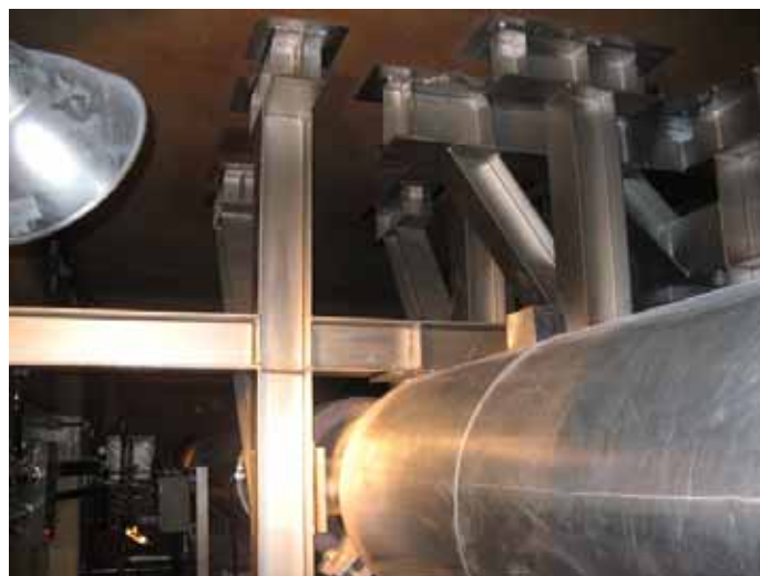
タービン建屋側：給水系配管，支持構造物
