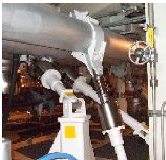
配管支持構造物
