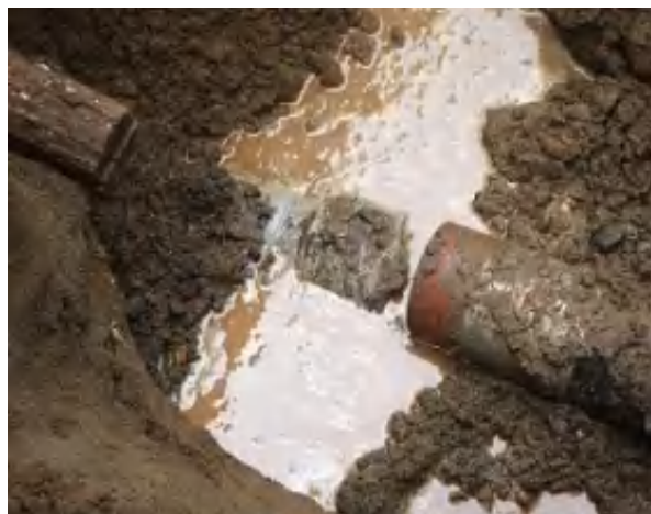
地中にある消火配管破損 （配管破断箇所 計4カ所）
