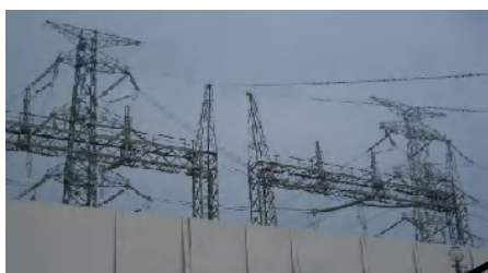
超高圧開閉所 (高起動変圧器)
