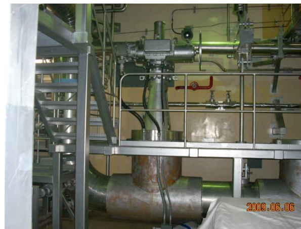
タービン駆動原子炉給水ポンプ吐出弁外観
