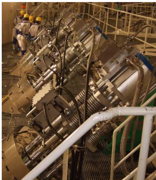
主蒸気隔離弁
