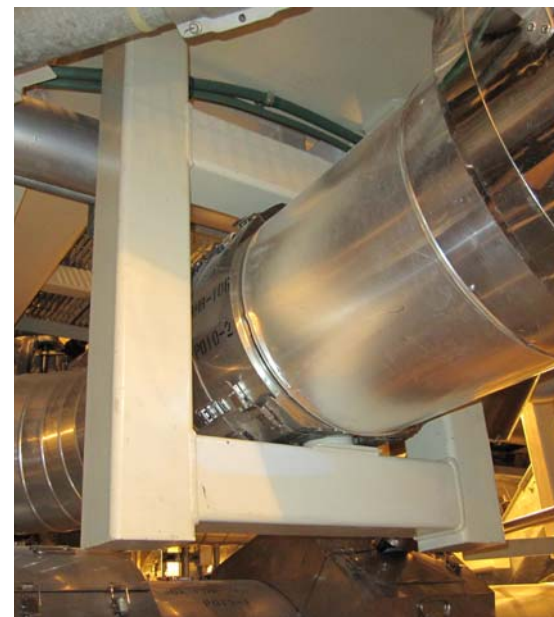
支持構造物 (残留熱除去系配管)
