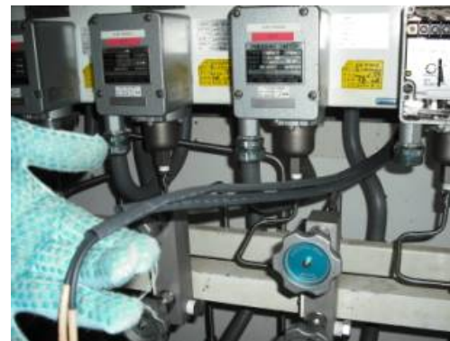
点検中地絡が発生した箇所 （絶縁処置箇所）
