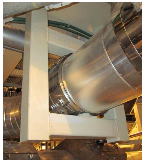
支持構造物 (残留熱除去系配管)
