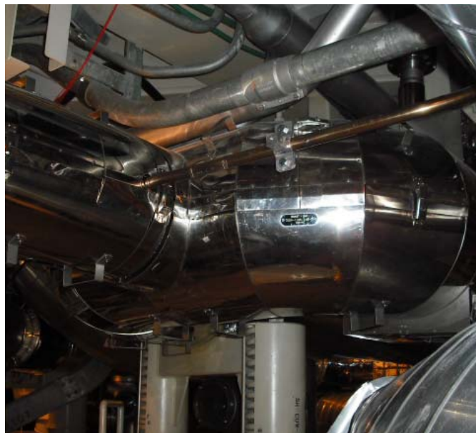
残留熱除去系配管
