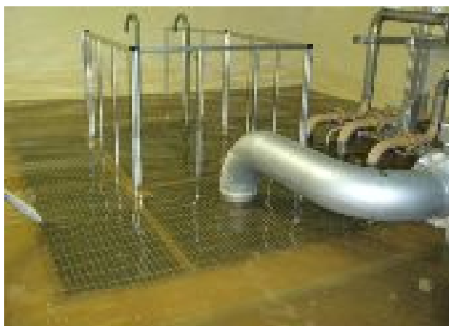
高電導度廃液サンプ（ A ）の冠水状況
