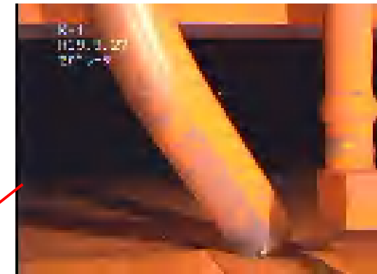
変形した仮置用脚部
