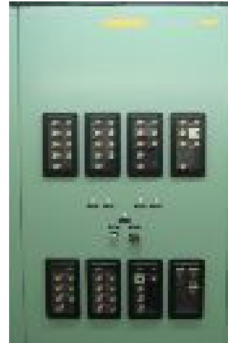
低圧炉心スプレイ系 A 系 残留熱除去系盤目視点検
