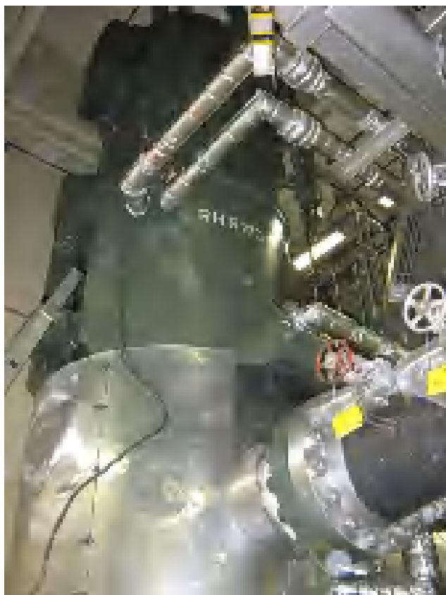
残留熱除去系ポンプ ( A ) 外観
