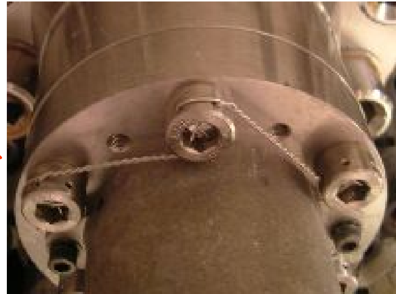
制御棒駆動機構フランジ部
