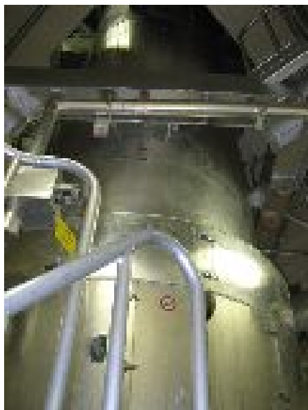
残留熱除去系熱交換器 ( A)外観
