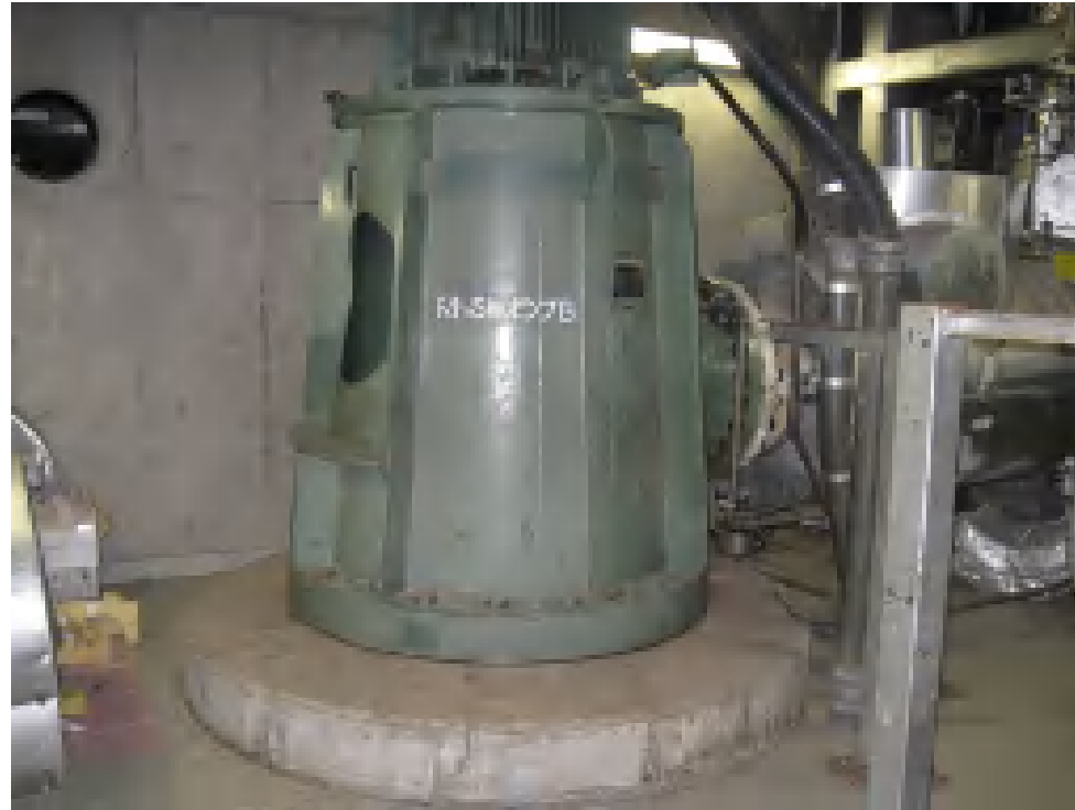
残留熱除去海水系ポンプ ( B ) 外観
