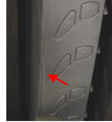
第13段タービン側シュラウドリング
