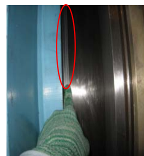
タービン軸 (タービンロータ) の軽微な接触痕
