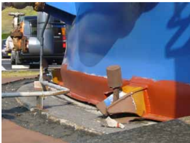
座屈したろ過水タンク
